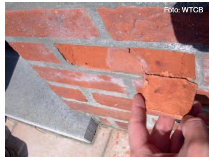
Afb. 6 Vorstschade aan bakstenen.
