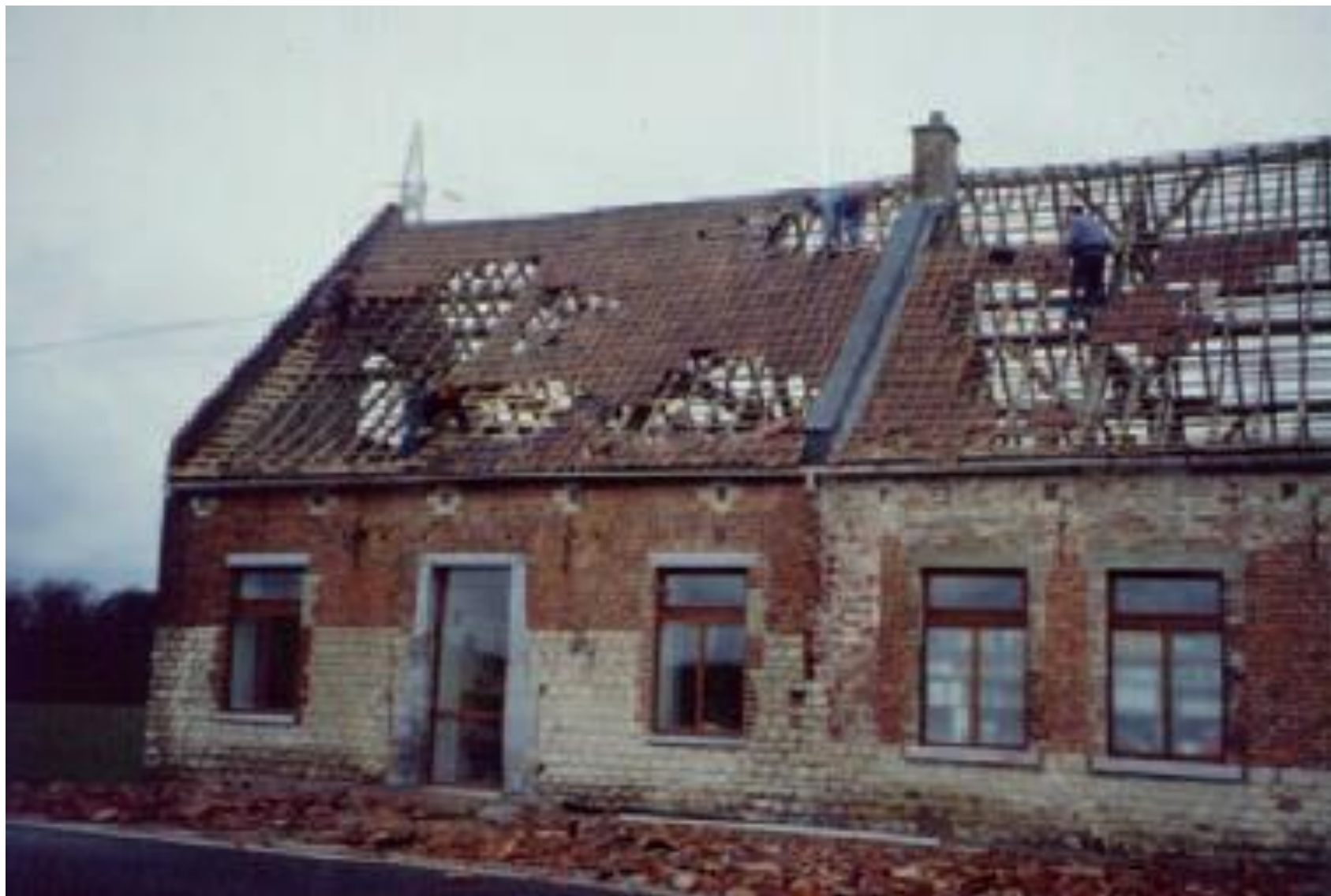
Afb. 51 Door de wind losgerukte dakbedekking.
