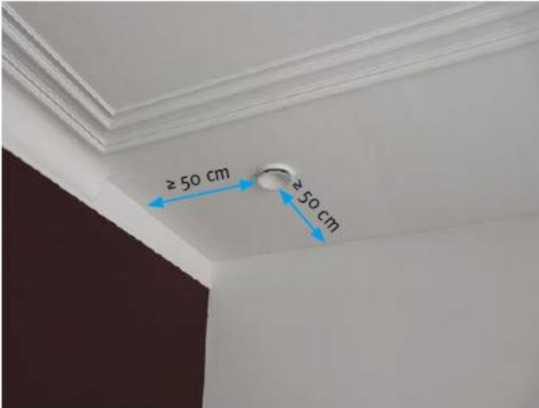
Afb. 42 Het ventiel moet op een toereikende afstand (minimum 50 cm) van de aangrenzende wanden gelegen zijn.
