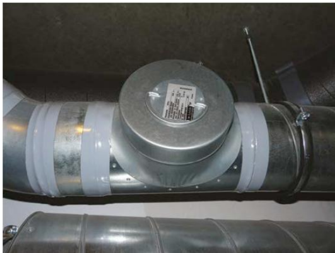
Afb. 71 Toegangsopening op een hoofdkanaal.
