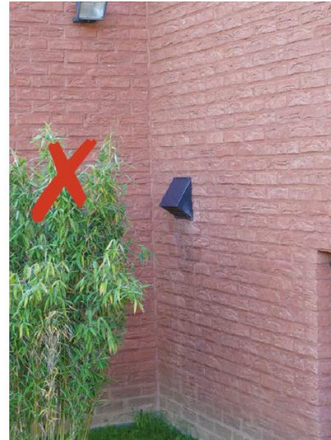
Afb. 22 Ongeschikte positie van een luchttoevoeropening, gelet op het risico op een overwoekering door de vegetatie.
