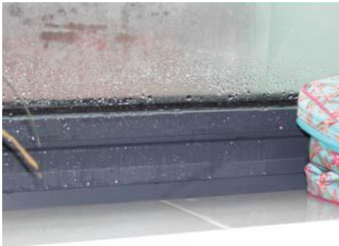
Condensatie op glas en raamprofiel - WTCB jaarverslag 2004
