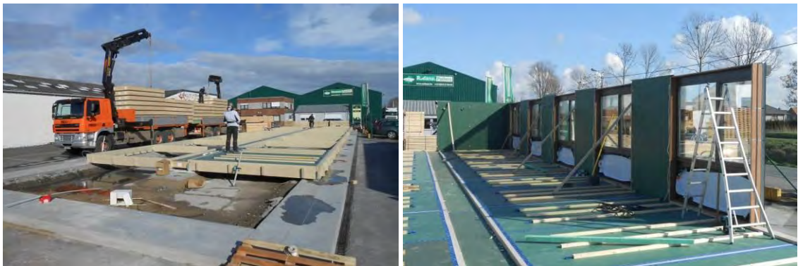
Figuur 3.37: (links) de ringbalken zijn op de fundering geplaatst waartussen de vloerelementen worden gelegd en in het midden de leidingschachten. (Rechts) geplaatste buitenwanden op de ringbalken. (Hahbo, 2014)
