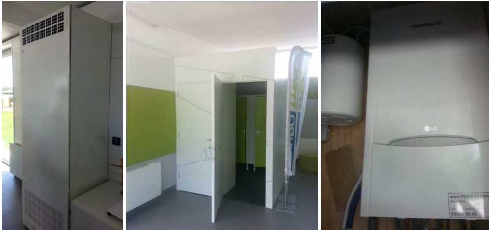
Figuur 3.41: (links) de ventilatie-unit. (Midden) de prefab sanitaire cel waarvan de linker deur van de meterkast is. (Rechts) de warmtepomp in de meterkast en rechtsboven de close-in boiler, onder de warmtepomp staat het buffervat van de warmtepomp (niet op de foto).
