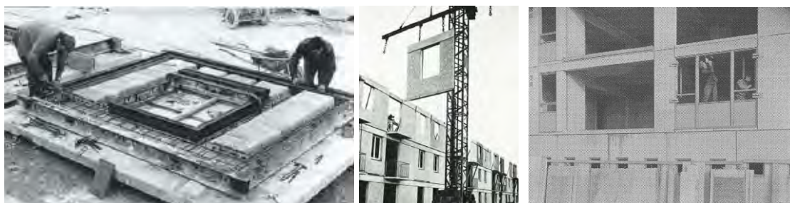
Figuur 0.3: Dragende geprefabriceerde gevelelementen uitgevoerd volgens het Frans Baretts systeem (links en midden); uitvoering op de bouwwerf van Sterrenveld/Zonneveld van de gevelelementen aan de lange gebouwzijden met lichte raamkaders en panelen. © Diamant, Industrialised Building 1 , p. 37-38 – © Archief Van Coillie
